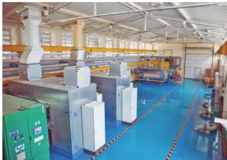
VMP工厂自主供电系统 斯维尔德洛夫斯克州阿拉米尔市
