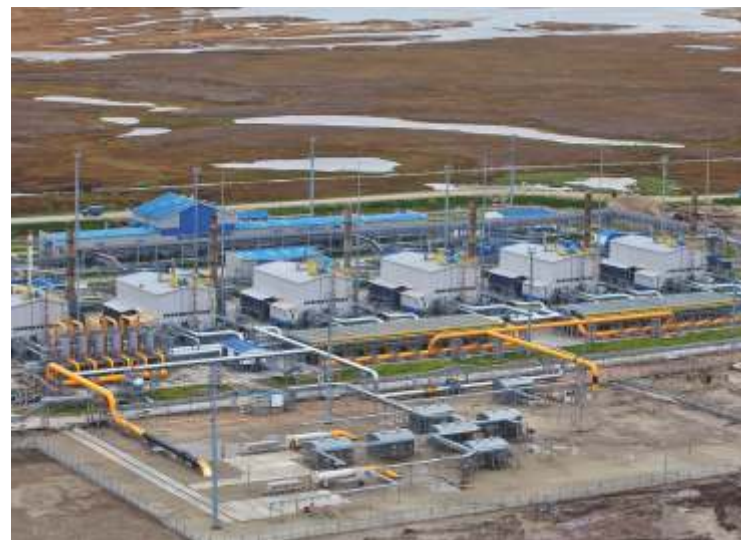
伯万涅克沃-乌赫塔天然气管道拜达拉压缩机站
