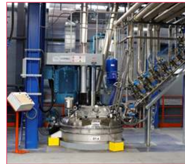
油漆生产车间，自动配量系统 斯维尔德洛夫斯克州阿拉米尔市
